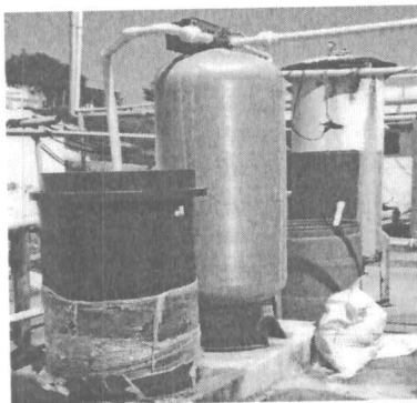
Foto 6. Sistema de tratamiento de aguas de caldera actualizado.
